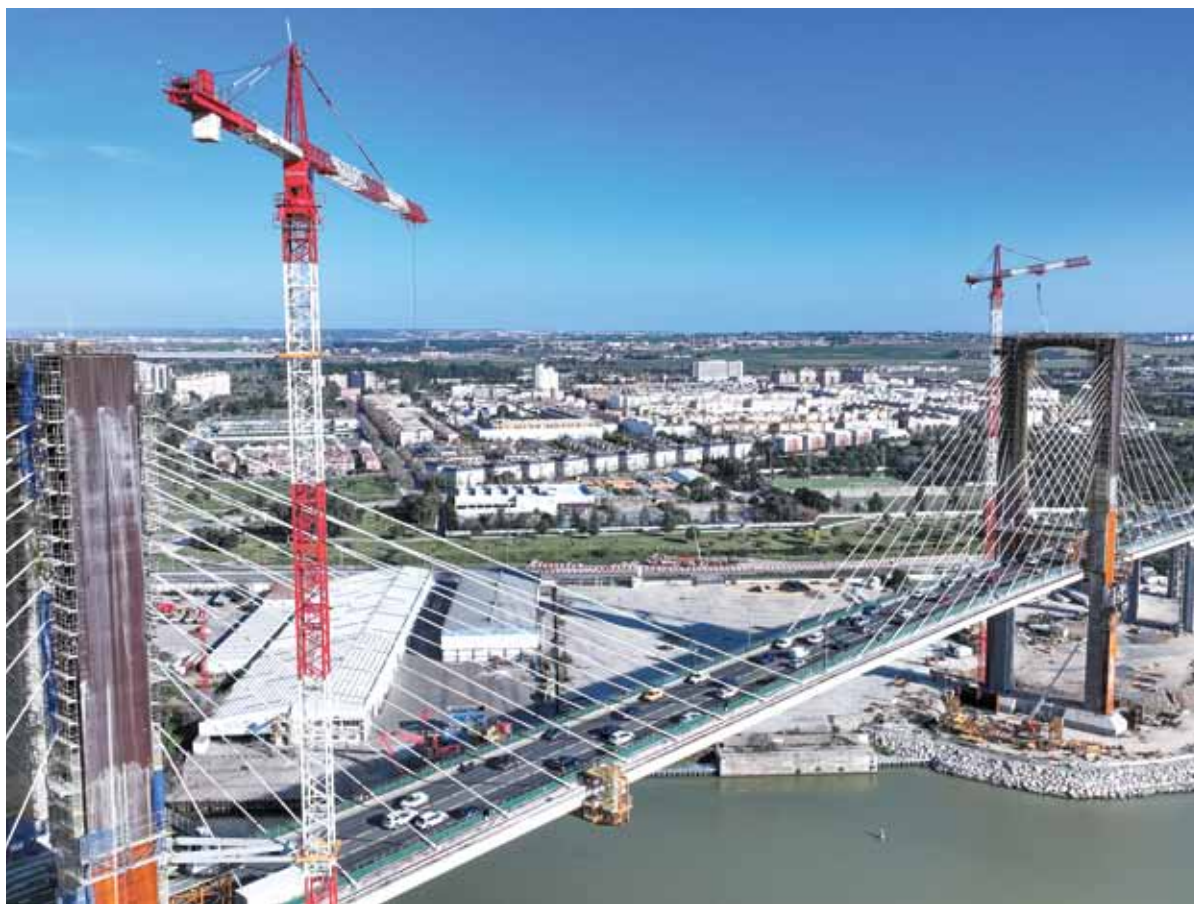
Die Brücke überspannt den Guadalquivir. Sie ist 1991 für den Verkehr freigegeben worden. Die damals angelegten drei Fahrspuren reichen nicht mehr. Zudem sind bei einer Inspektion Schäden festgestellt worden – daher die umfassende Sanierung mithilfe der Liebherr-Krane. Foto: Liebherr
