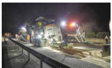
Moderne LED-Beleuchtung sorgte für genug Licht beim Einsatz. Foto: Wirtgen Group
